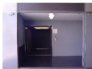
搬入用エレベーター
