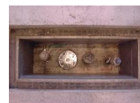
給水口 ガス取出口 排水ピット
