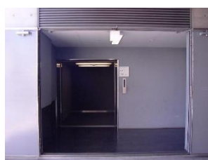
搬入用エレベーター
